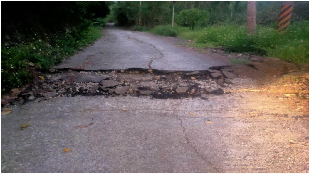
圖2-16 電光里15鄰產業道路道路龜裂情形
