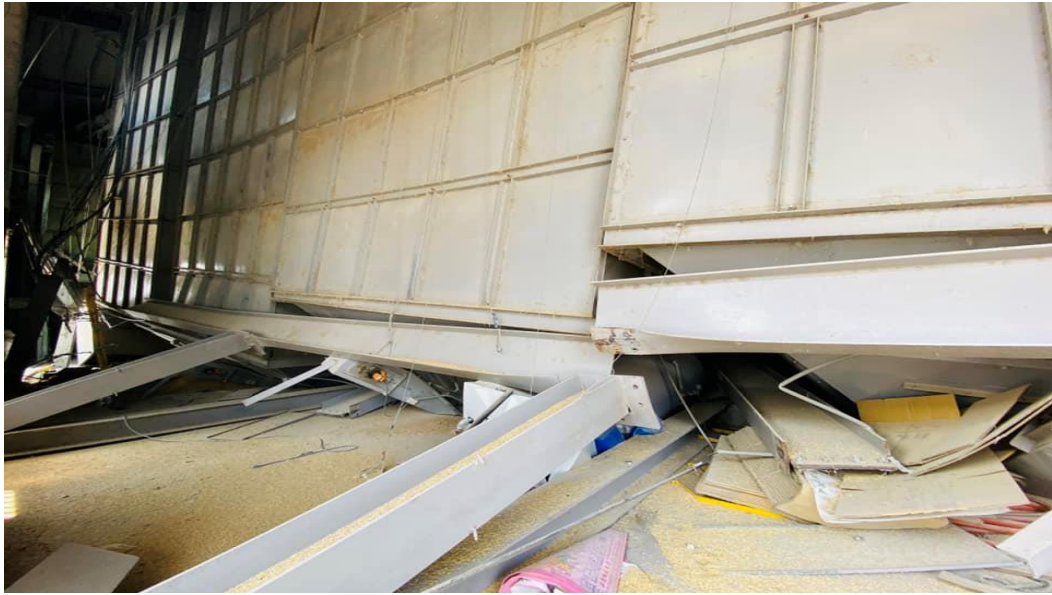
圖2-14 新乾坤米廠建物倒塌情形
