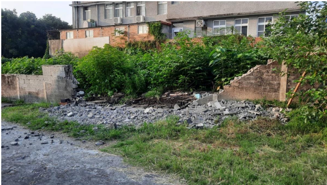
圖2-17 關山鎮公家廳舍建物災損情形
