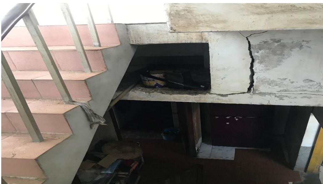
圖2-18電光里民宅建物龜裂情形
