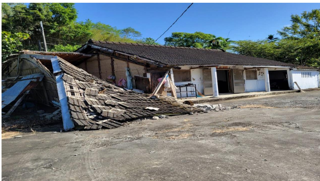
圖2-19 電光里民宅建物倒塌情形
